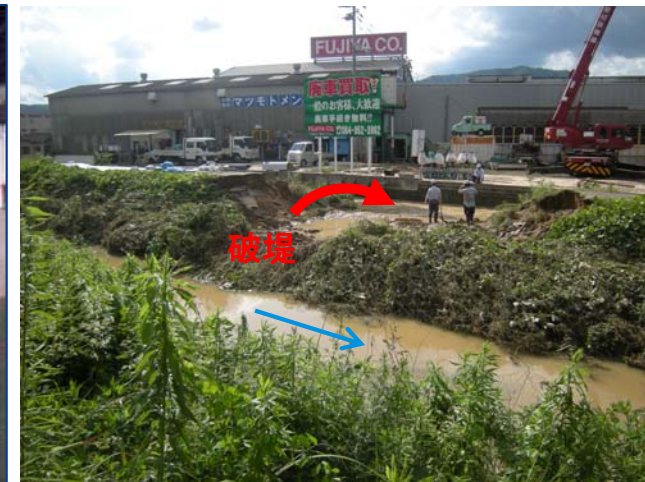
平成28年6月 梅雨前線豪雨 瀬戸川支川の猪之子川破堤（福山市）
